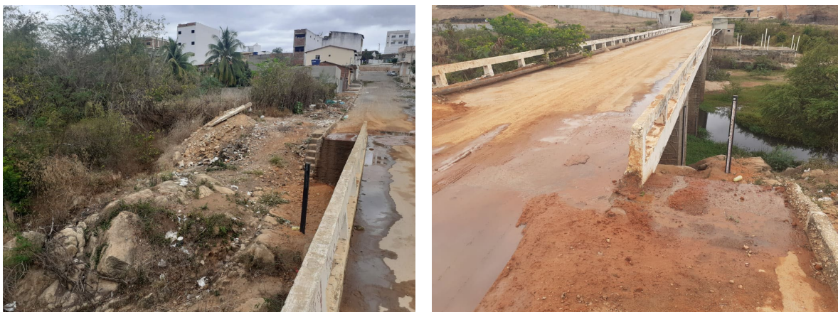
Figuras 2 e 3: Esgotos domiciliares sendo lançados no Rio Gavião, na cidade de Anagé-BA.
